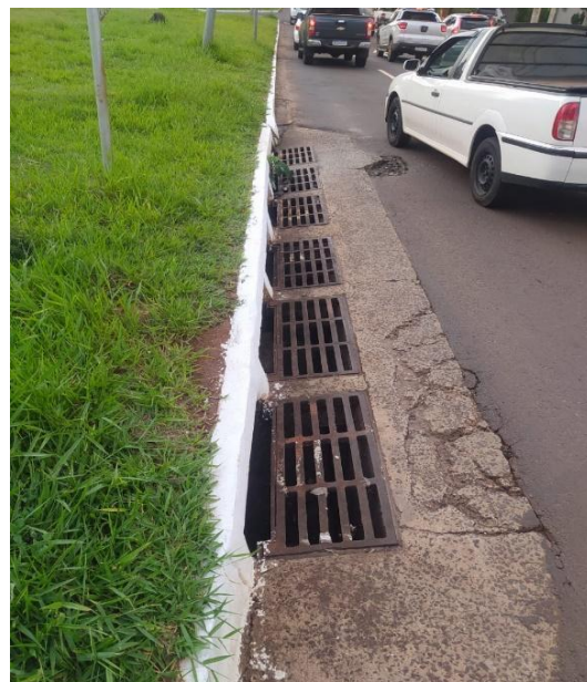
Figura 60 – Boca de lobo da Av. Dr. Paulo Machado
