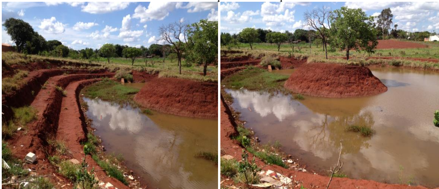
Foto 55 e 56 – Bacia de retenção com infiltração da Vila Marli.
