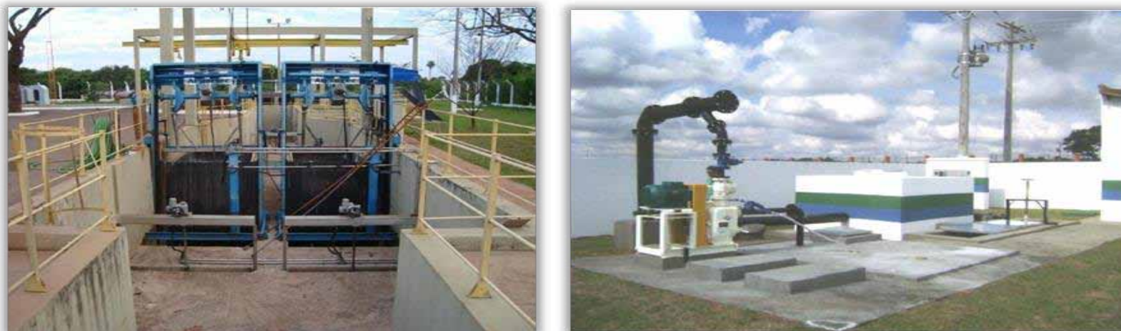
Fotos 16 e 17 – Estação Elevatória Los Angeles(EEE-030) e Alphaville (EEE-032)
