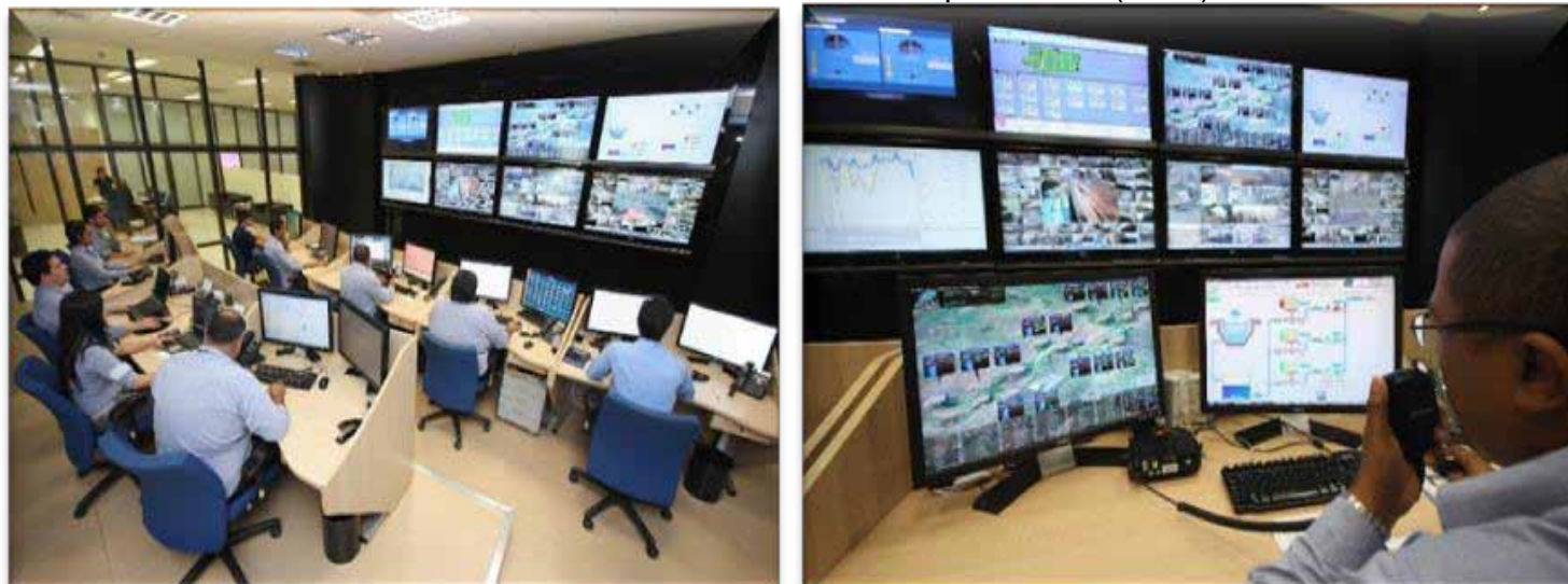
Fotos 10 e 11 – Centro de Controle Operacional (CCO).
