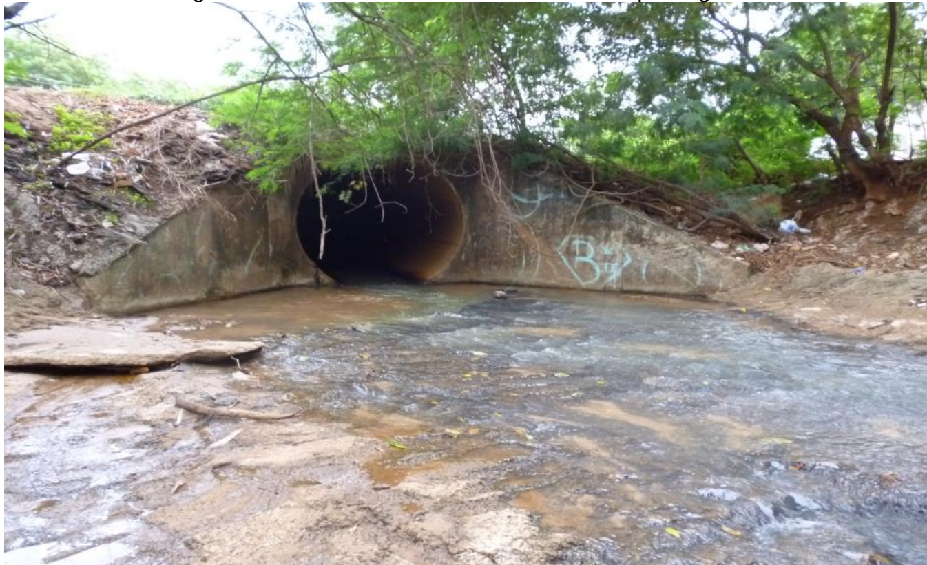
Foto 49 – Córrego Bálamo com Av. Guaicurus contaminado por esgotamento sanitário.
