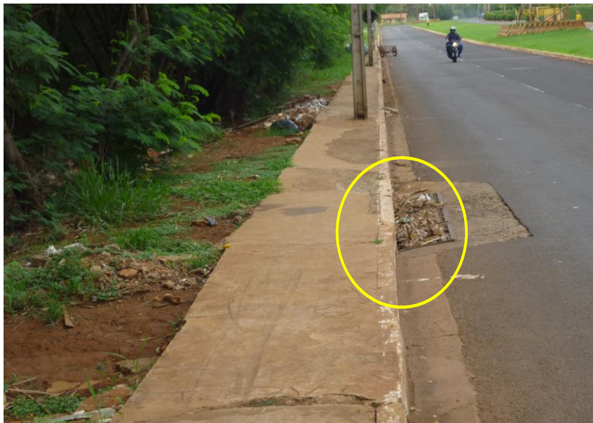
Foto 54 – Bueiro entupido por resíduos sólidos na Av. Guaicurus.
